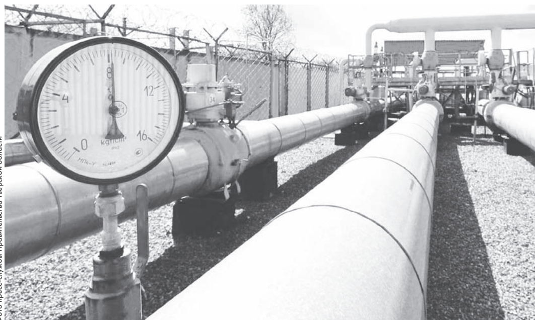
В Тверской области завершено строительство двух газопроводов в Сонковском и Лихославльском округах
